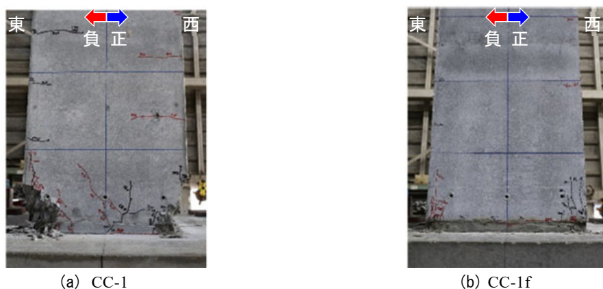
写真-1 最終破壊状況 (柱脚部)
